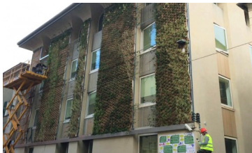
Si lavora per allestire la parete verde sul palazzo Inps di via Menotti a Sestri Ponente
