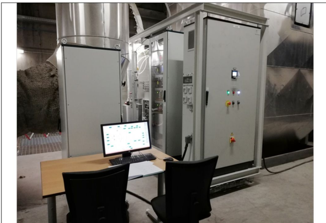
Figura 2 – Impianto pilota Rse per l'abbattimento combinato particolato di combustione/NOx in esercizio presso la centrale termica di Tcvvv in Tirano (SO)
