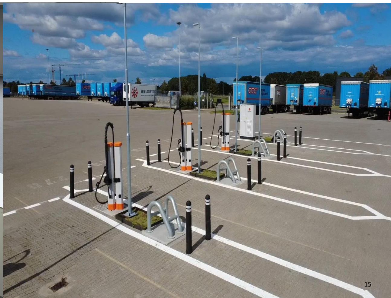
Stazione di ricarica realizzata
